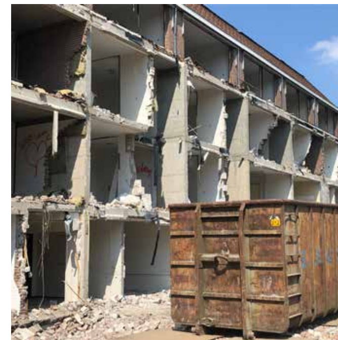
Na de oplevering van fase 1 kon gestart worden met de sloop van het oude gebouw. (Beeld: Hendriks Bouw en Ontwikkeling)
